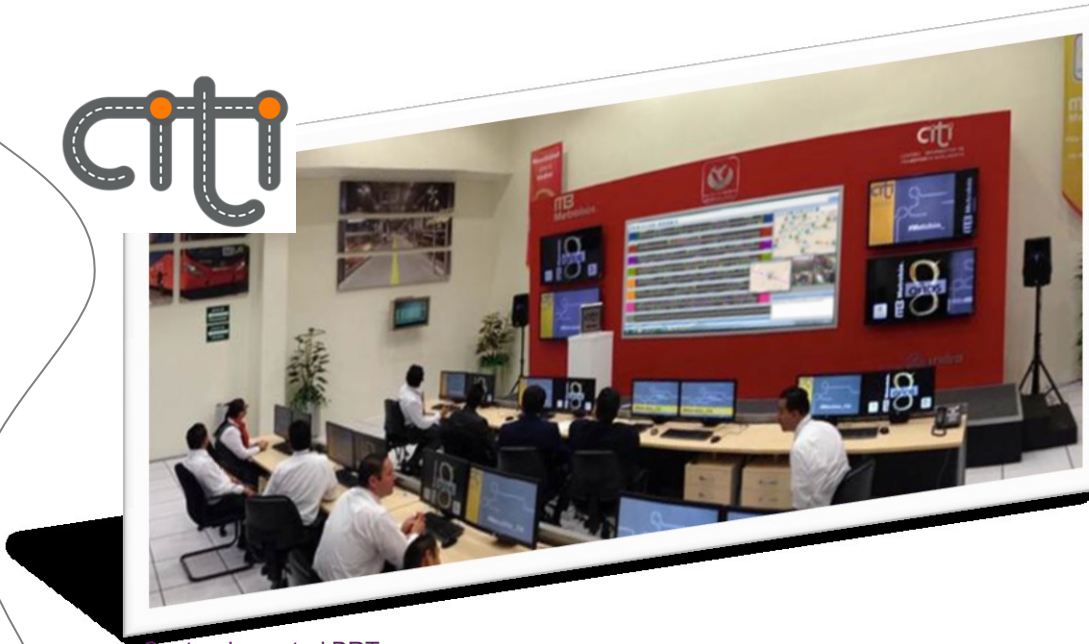
Centro de control BRT-México
